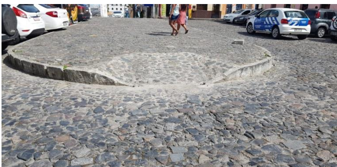
Foto 2: Rampa fora da norma
